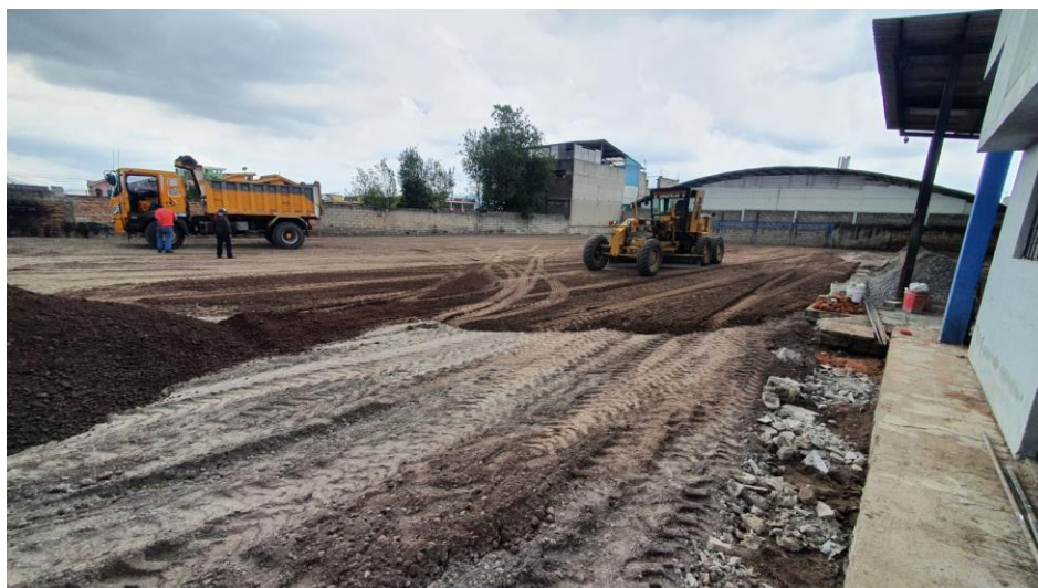
Ilustración 46 Tendido y compacto de Sub base clase 2 Fuente: Ing. Bryan Logacho Responsable de Obras Civiles
